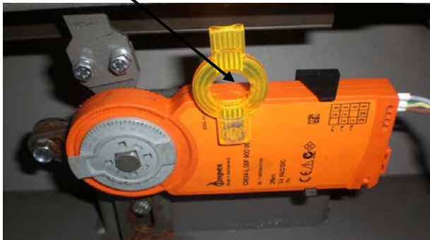
Handbetrieb bei Stromausfall
